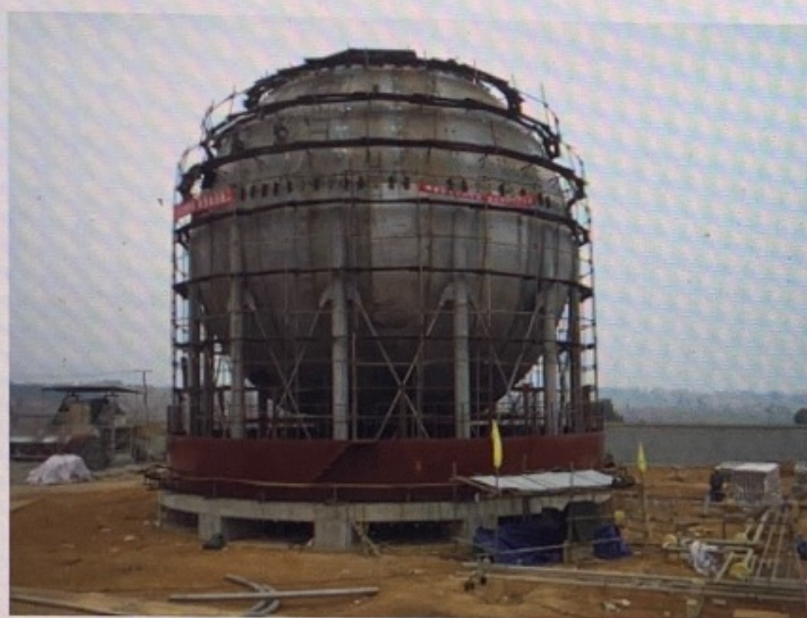
2500m 3 LNG spherical tank for Yunnan...
